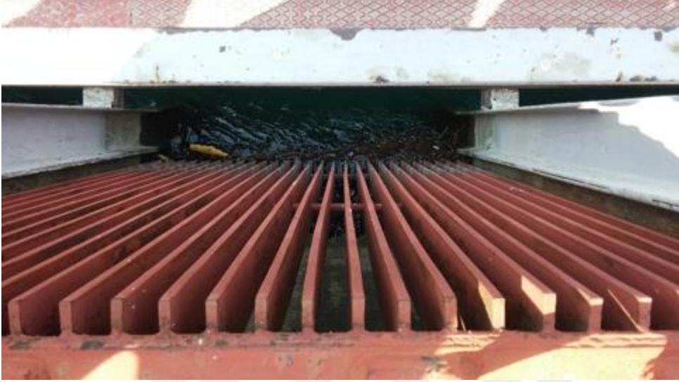
Şekil 2.3: Yükleme havuzu enerji tüneli su alma yapısı ızgarası görünümü [39].
