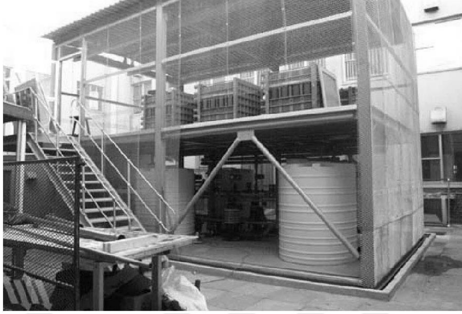
Şekil 2.23 : 250 kW güç üretebilen vanadyum redoks akış bataryası sistemi (Lotspeich, 2002).
